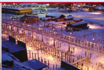
Strømdistribusjonsnett i Mo Industripark
